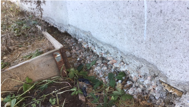
Noe utgliding av masse under ringmur
