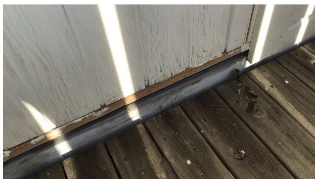
sprekker i maling på balkongdør på lof
