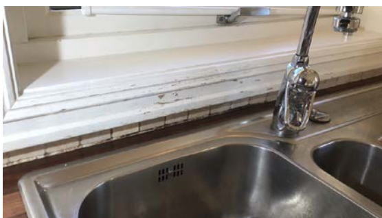
Fukt merker under vindu ETASJE > STUE/KJØKKEN
