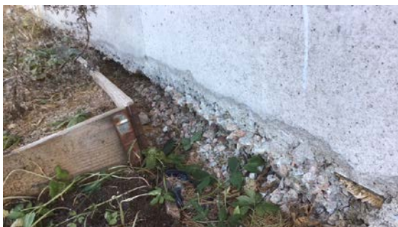
Noe utgliding av masse under ringmur
