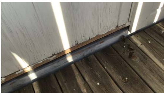
sprekker i maling på balkongdør på lof
