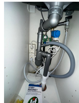
Rørpropp i kjøkkenbenk med Waterguard
