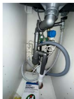
Røropplegg i kjøkkenbenk med Waterguard
