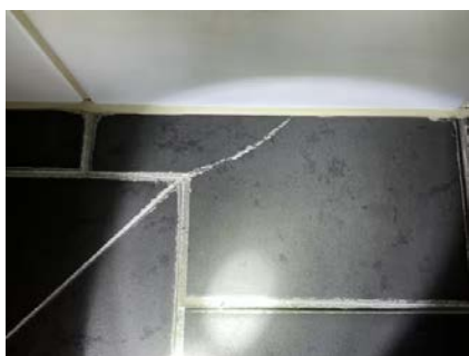
Riss/sprekk på flis i dusj-sone.
