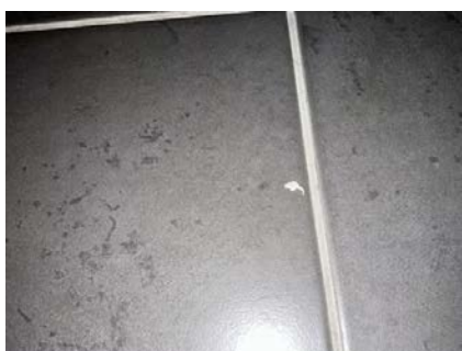
Skade på flid ved vask.
