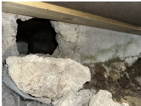
Mindre luke i ringmur uten adkomst. Luke bør tettes med netting.
