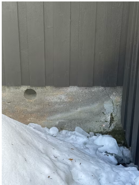
Det registreres sprekker i ringmur.
