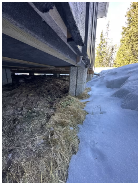
Det registreres skjevheter ved fundament.
