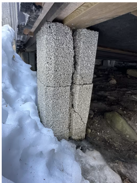
Det registreres sprekk i fundament.
