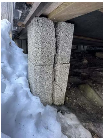
Det registreres sprekk i fundament.
