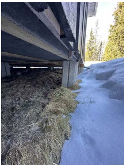
Det registreres skjevheter ved fundament.
