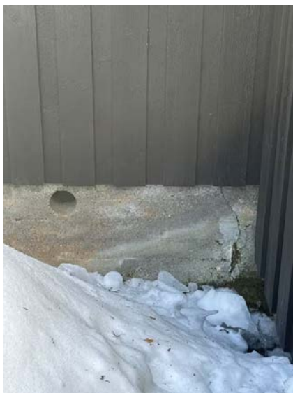
Det registreres sprekker i ringmur.
