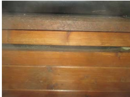
Bra med luftespalter i gesimsen for lufting av kaldtloftet.
