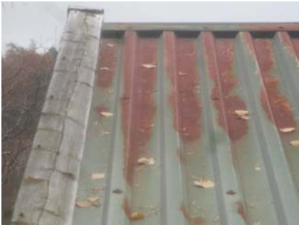
Noe rust på takplater.
