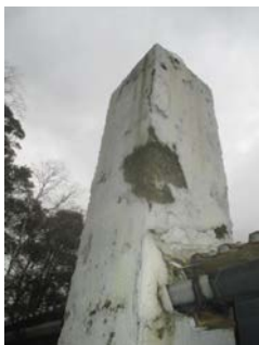
Større avskalling på utvendige elementer.
