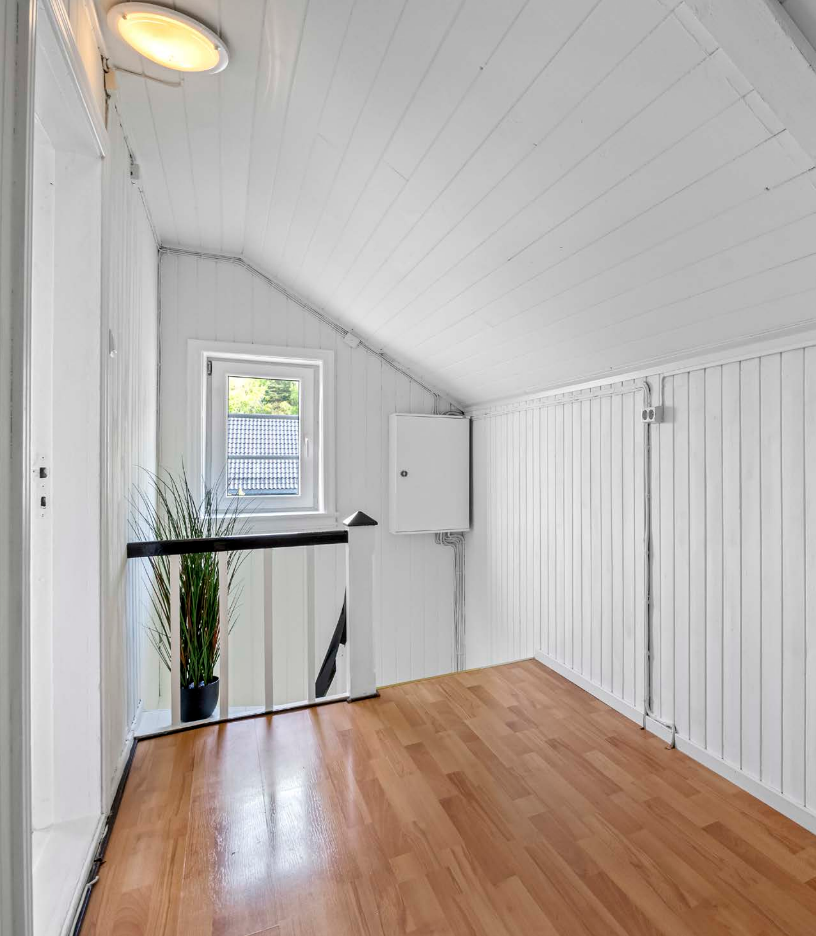
Gang. Her er sikringsskap med automatsikringer plassert.
