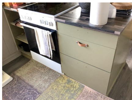
Manglende håndtak på deler av innredning.
