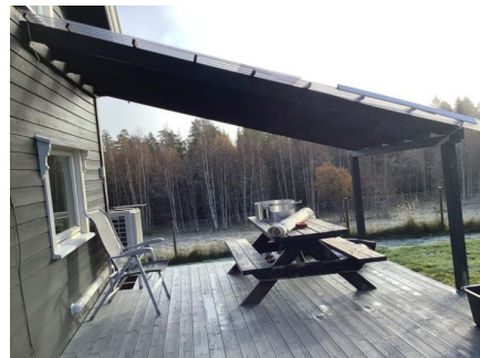
Delvis takoverbygget. Taket er underdimensjonert.
