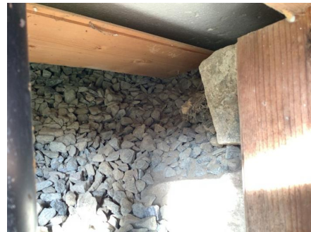
Det er registrert isopor under bjelkelaget fra luke i krypekjeller.
