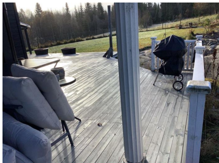
Vedlikeholdsarbeider må påregnes.
