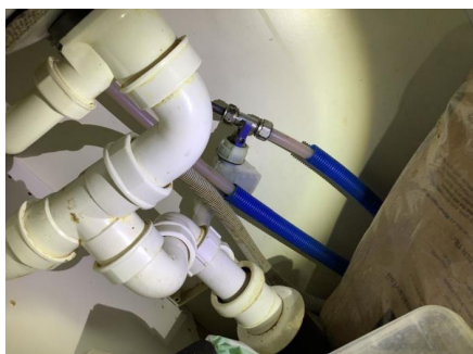
Vannrør har ikke tette muffer mot varerør.
