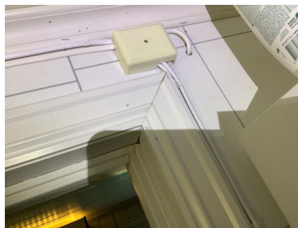
Ufagmessig utførelse av veggplater og el-opplegg.
