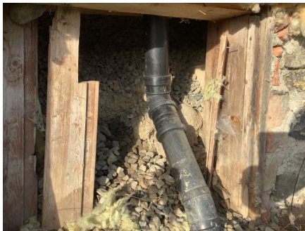
Inngang til krypekjeller er blokkert. Bildet viser også avløpsrør fra kjøkken, se kommentar under "Avløpsrør"
