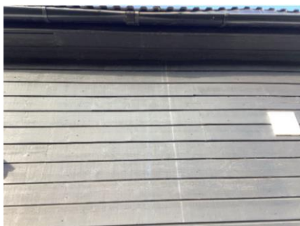
Stripe på kledning tyder på lekkasje i undertak, eller kondens fra skråtak på vinterstid. Anbefaler videre undersøkelser.
