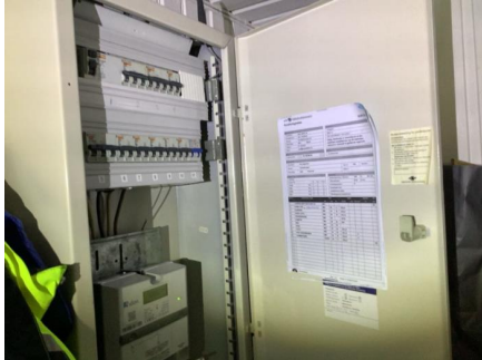
El-skap med automatsikringer.
