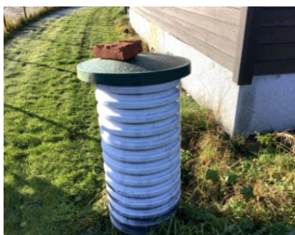
Opplyst å være gråvannskum fra avløp kjøkken. Ikke undersøkt tilstand.
