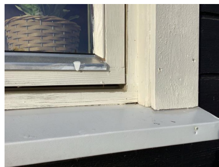
Værslitte karmen på vinduer.
