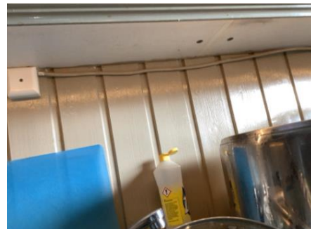
Ufagmessig el-opplegg, kjøkken.
