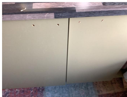
Manglende håndtak på deler av innredning.
