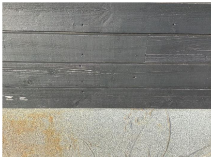
Vedlikehold av kledningen er påkrevet.
