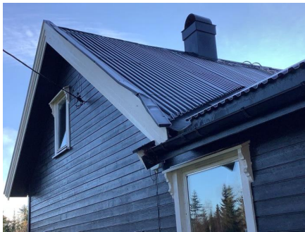
Beslag og vindskier er bøyd pga is/snøras.
