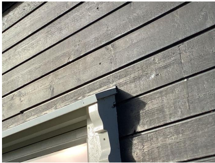
Beslag over vinduer er feil avsluttet mot kledning.
