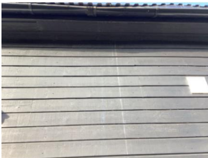
Stripe på kledning tyder på lekkasje i undertak, eller kondens fra skråtak på vinterstid. Anbefaler videre undersøkelser.
