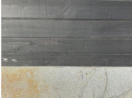
Vedlikehold av kledningen er påkrevet.
