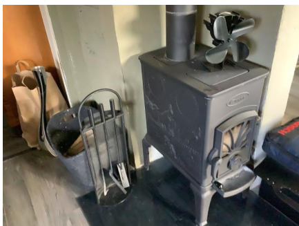
Vedovn har kort avstand til brannmur.
