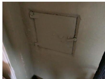
Feieluke er plassert i stue/gang. Det mangler ubrennbar plate på gulv under feieluke.
