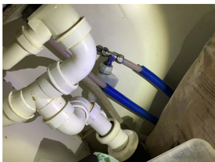
Vannrør har ikke tette muffert mot varerør.
