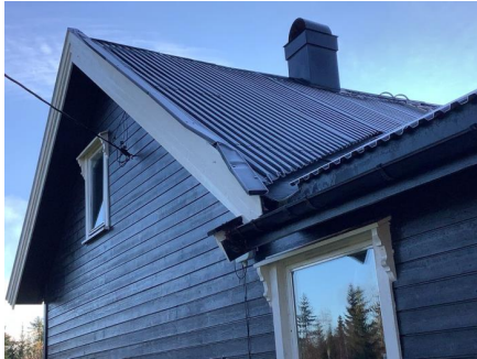
Beslag og vindskier er bøyd pga is/snøras.
