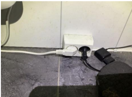
Ufagmessig el-opplegg mot gulv i våtrom.
