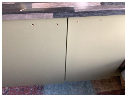
Manglende håndtak på deler av innredning.
