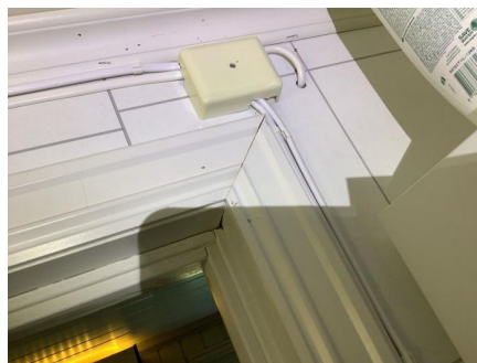
Ufagmessig utførelse av veggplater og el-opplegg.
