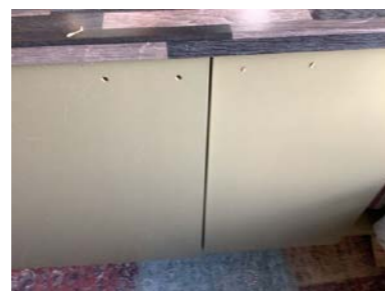
Manglende håndtak på deler av innredning.
