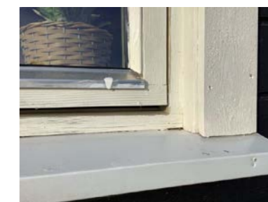
Værslitte karmen på vinduer.
