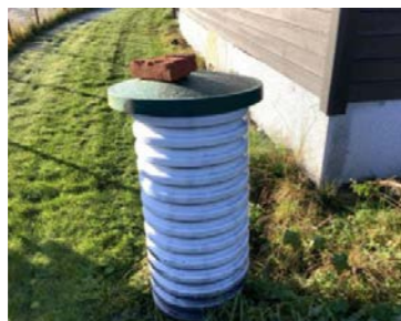
Opplyst å være gråvannskum fra avløp kjøkken. Ikke undersøkt tilstand.
