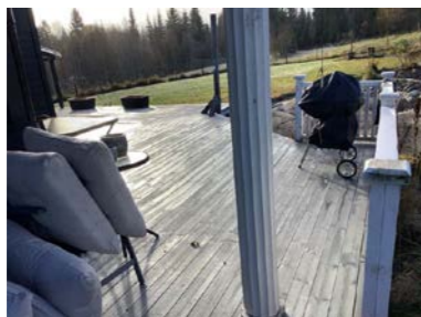
Vedlikeholdsarbeider må påregnes.
