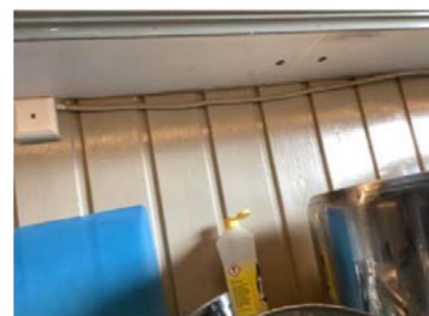
Ufagmessig el-opplegg, kjøkken.
