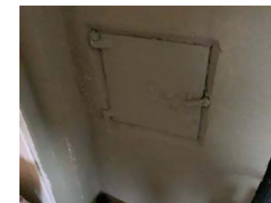
Feieluke er plassert i stue/gang. Det mangler ubrennbar plate på gulv under feieluke.
