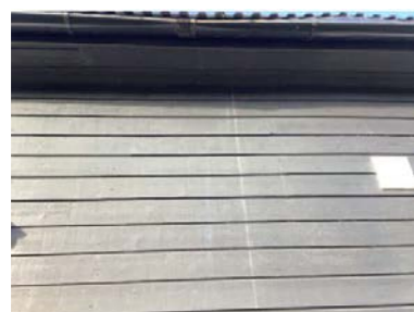
Stripe på kledning tyder på lekkasje i undertak, eller kondens fra skråtak på vinterstid. Anbefaler videre undersøkelser.
