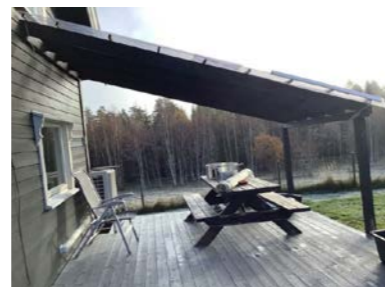
Delvis takoverbygget. Taket er underdimensjonert.
