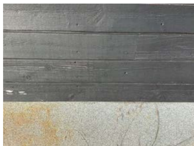
Vedlikehold av kledningen er påkrevet.
