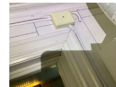
Ufagmessig utførelse av veggplater og el-opplegg.
