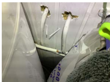
Eldre skrukoblinger og kobberrør.
