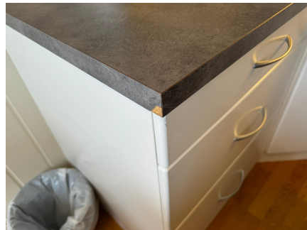
Skade på benkeplate.
