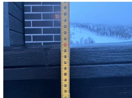
Rekkverkshøyde på altan ved stuen.
