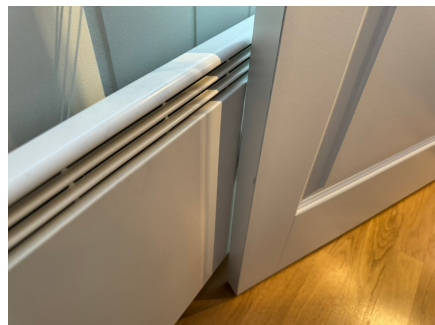
Døren står mot panelovn i åpen stilling.
