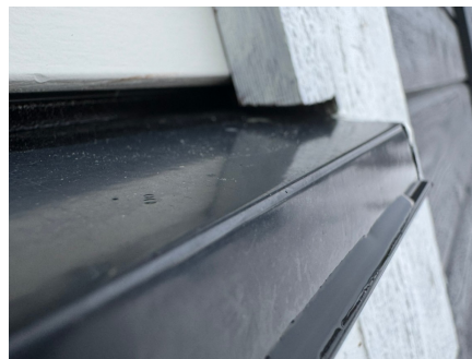
Manglende oppbrett på beslag.
