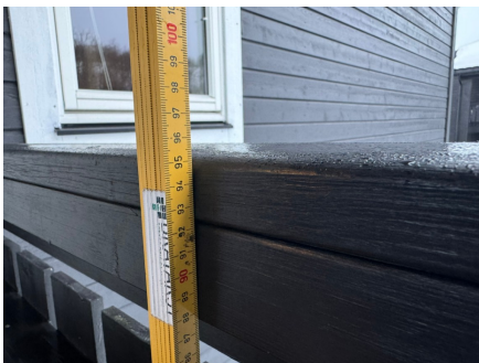
Rekkverkshøyde på altan ved hovedytterdøren.
