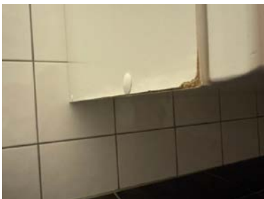
Fuktskader på innredningen.
