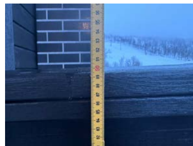
Rekkverkshøyde på altan ved stuen.
