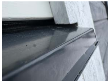
Manglende oppbrett på beslag.
