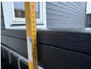
Rekkverkshøyde på altan ved hovedytterdøren.
