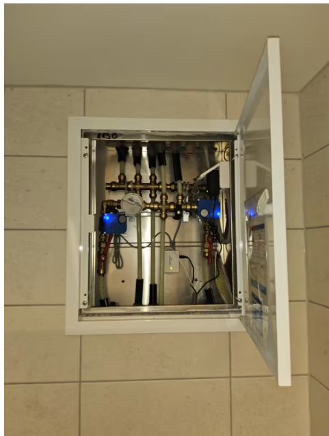
Vannfordelerskap med stoppekraner er plassert på bad.
