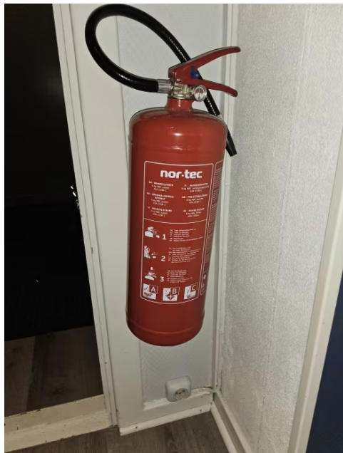
Brannslukningsapparat montert ved entré/stue.
