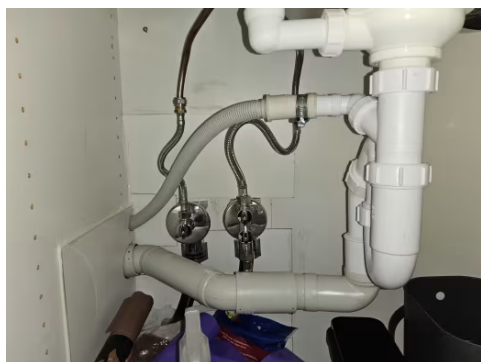
Synlige avløpsrør er av av plast.
