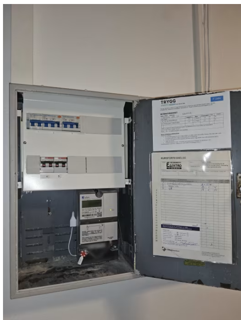
Sikringskap er plassert i felles gang.
