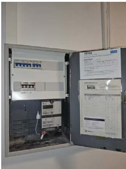
Sikringskap er plassert i felles gang.
