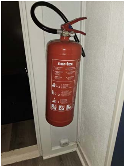
Brannslukningsapparat montert ved entré/stue.
