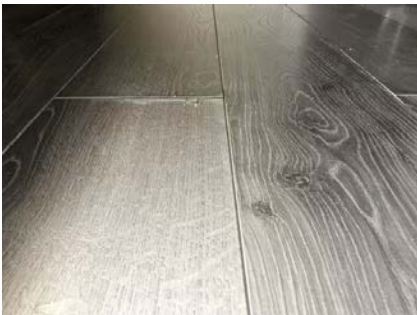
Det registreres enkelte svelleskader og gliper i skjøter på laminatgulv.
