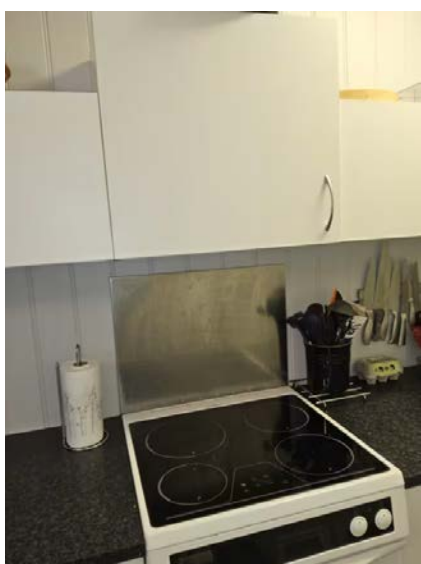
Det er ikke etablert mekanisk avtrekk over komfyr.
