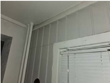
Overflater bærer preg av ufagmessig utførelse.
