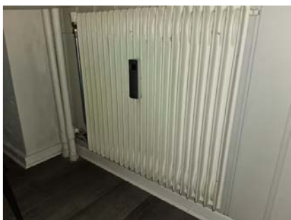
Leiligheten er i hovedsak oppvarmet med radiatorer.
