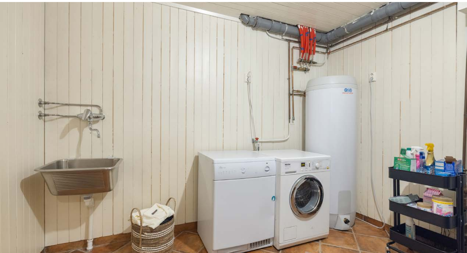
I kjeller er det et eget vaskerom med opplegg for vaskemaskin, tørketrommel og utslagsvask i stål.
