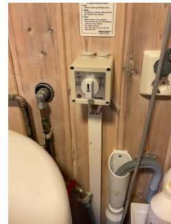
Bryter for varmekabel i utvendige vannrør.
