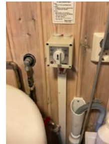
Bryter for varmekabel i utvendige vannrør.
