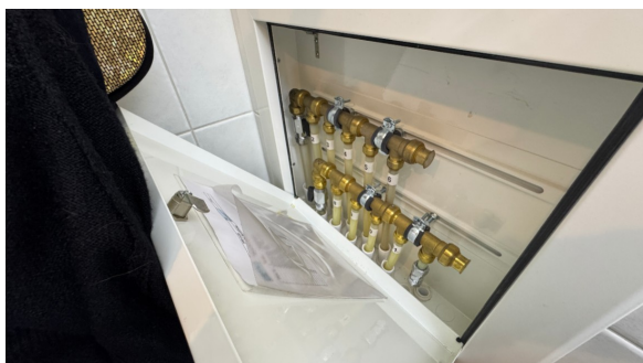
Kontroll av rørfordelerskap.
