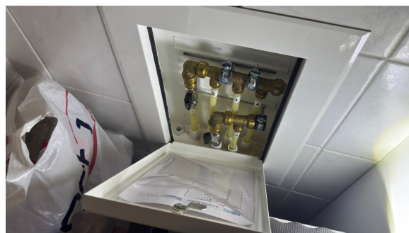
Kontroll av rørfordelerskap.
