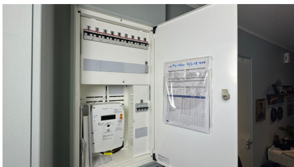
Kontroll av el-skap og kursfortegnelse.
