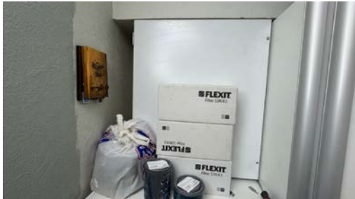
Ventilasjonsaggregat er plassert i skyvedørgarderobe i gangen.
