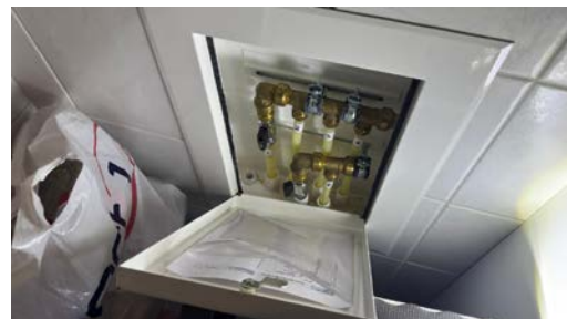
Kontroll av rørfordelerskap.
