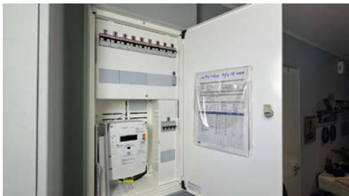
Kontroll av el-skap og kursfortegnelse.
