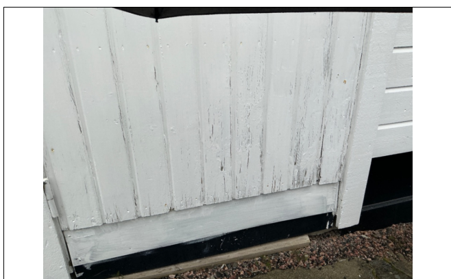
Dør i sidevegg har slitasje og dårlig treverk nederst på dørblad
