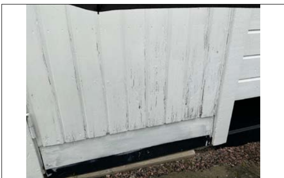
Dør i sidevegg har slitasje og dårlig treverk nederst på dørblad
