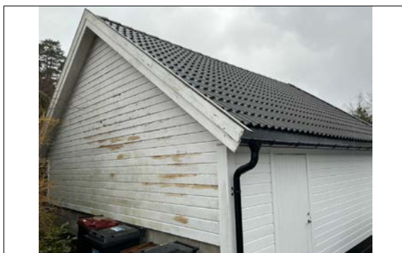
Generelt behov for vedlikehold av fasader på garasje
