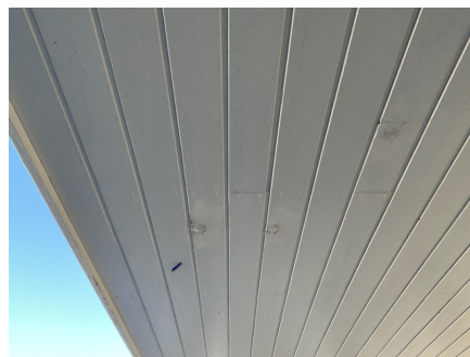
Skjolder i undertak.
