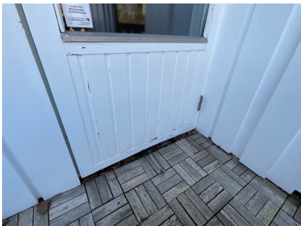
Terrassedør i stue med alderslitasje.
