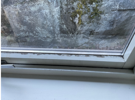
Vindu med malingsflass.
