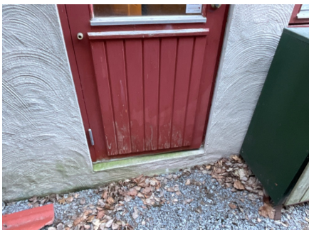
Terrassedør i kjeller med alderslitasje.
