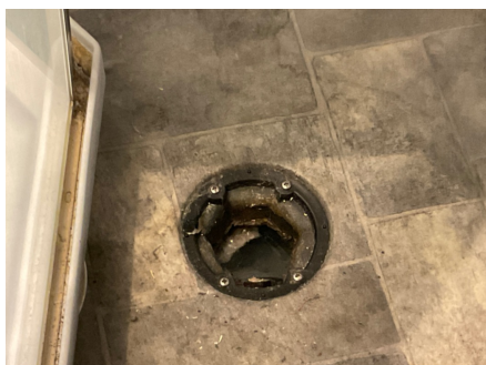
Sluk under dusjkabinett
