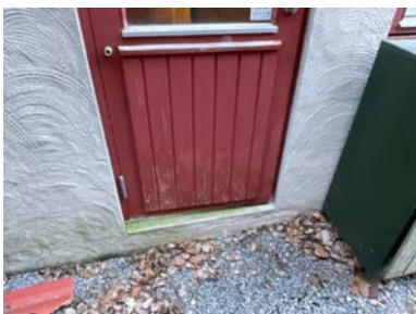
Terrassedør i kjeller med alderslitasje.
