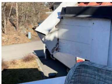
Vindskie med begynnende råte.
