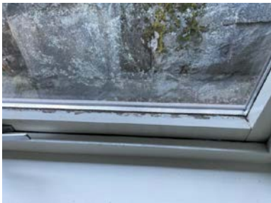
Vindu med malingsflass.
