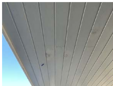
Skjolder i undertak.
