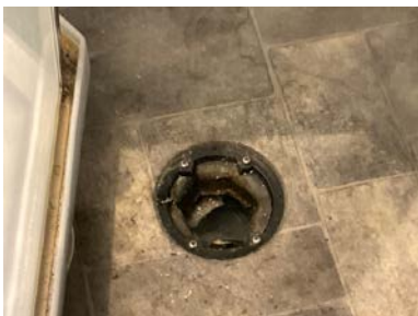
Sluk under dusjkabinett
