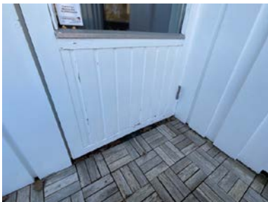
Terrassedør i stue med alderslitasje.
