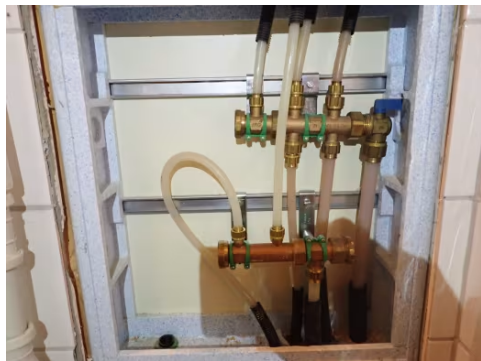
Rørskap med stoppekrane på bad.
