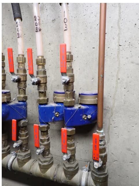
Stoppekrane i kjeller i fellesareal.
