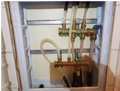
Rørskap med stoppekrane på bad.
