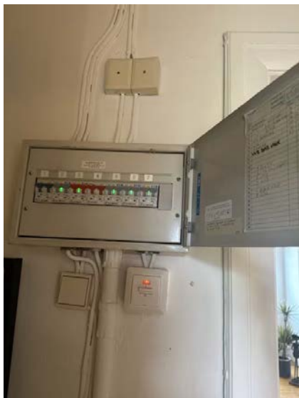
Sikringsskap er plassert i entre/gang. Kursfortegnelse på innerside skapdør.
