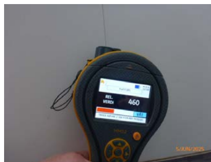
446, plateskjøt på vegg noe opp på plater inne i dusjnisen
