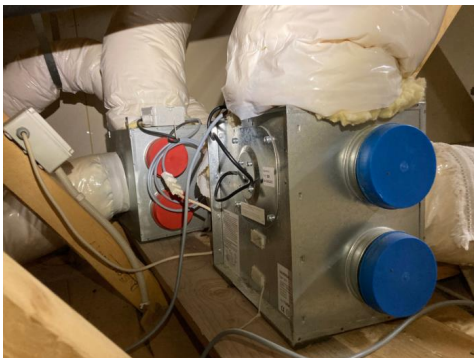
Avtrekksmotorer for leiligheten og leilighet under på møneloft.
