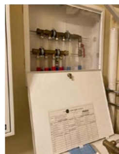
Fordelerskap med stoppekran.
