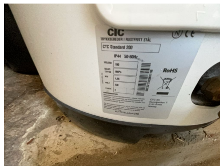
Spekk på varmtvannstank.
