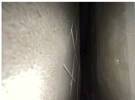
Sluk under dusjkabinett.
