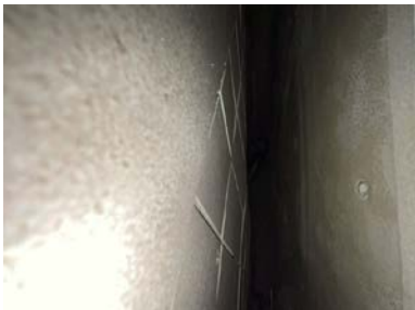
Sluk under dusjkabinett.
