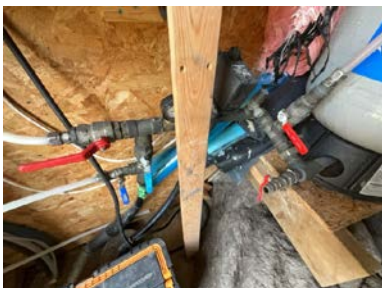
Stoppekran til vann.
