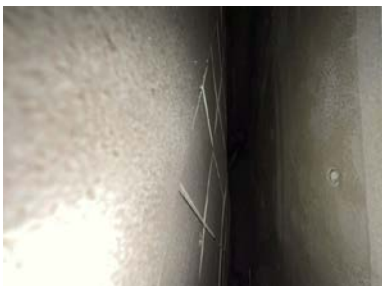
Sluk under dusjkabinett.
