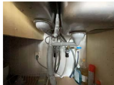
Del av rør til avløp.
