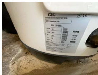
Spekk på varmtvannstank.
