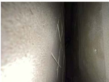
Sluk under dusjkabinett.
