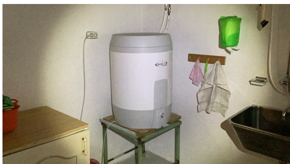
Varmtvannstank på vaskerom.
