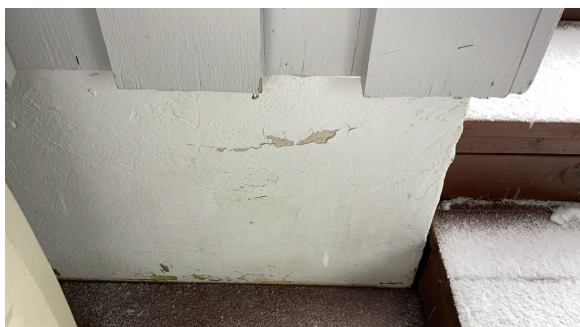
Malingsflass på mur.
