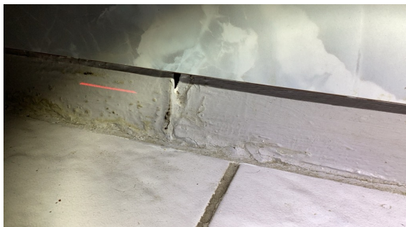
Sprekk i membran.
