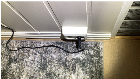
Gulv er ikke ført tilstrekkelig under list.
