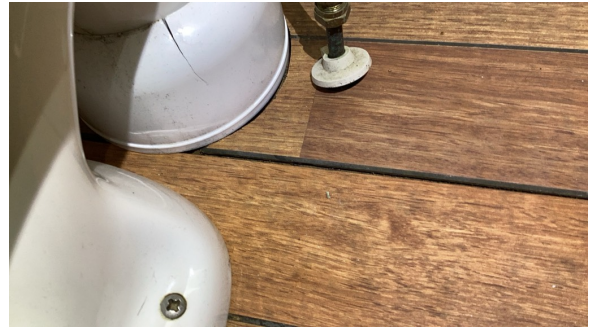
Svelling på laminat ved toalett.
