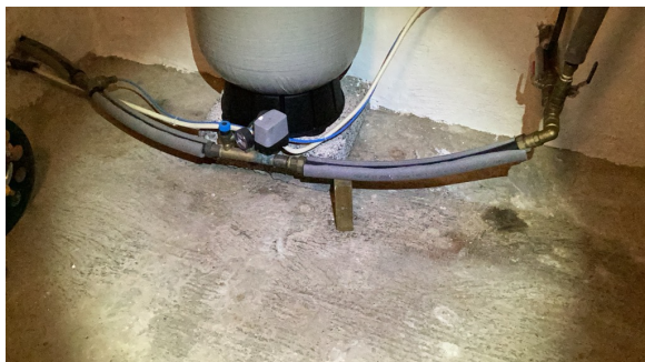
Stoppekran i kjeller.
