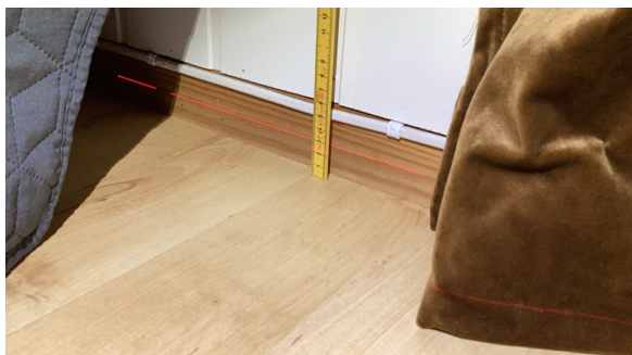
Helningsavvik på 17 mm ble målt på soverom.
