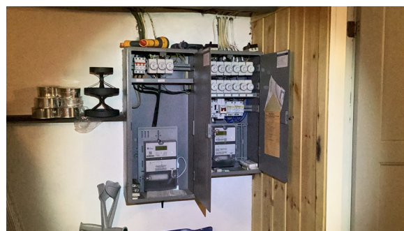
Sikringsskap i kjeller.
