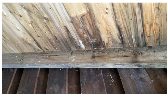
Misfarging på undertaksbord i garasjedel.
