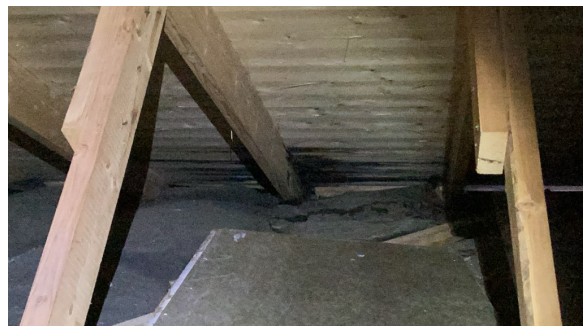
Misfarging på undertak.
