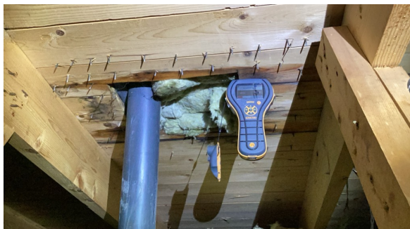
Fuktmåling ble foretatt, jeg målte skadelig fukt.
