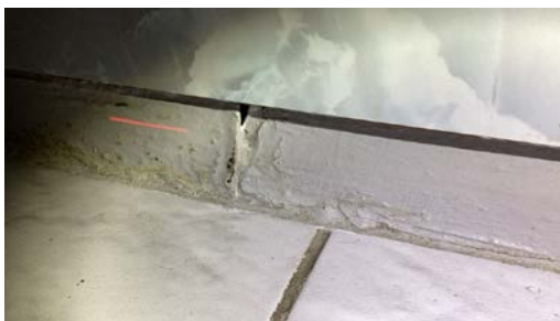
Sprekk i membran.
