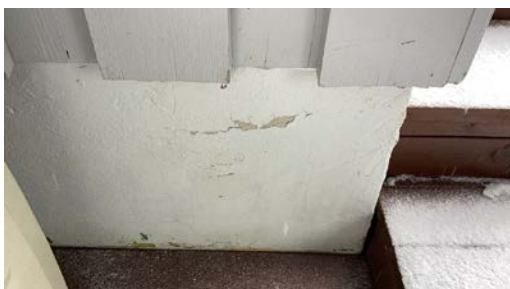
Malingsflass på mur.
