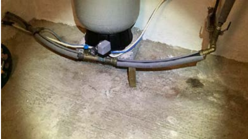
Stoppekran i kjeller.
