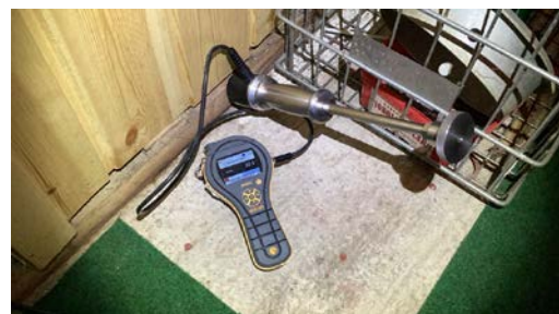
Fuktmåling ble foretatt, jeg målte skadelig fukt.
