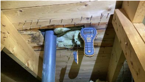
Fuktmåling ble foretatt, jeg målte skadelig fukt.
