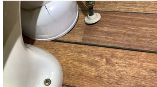
Svelling på laminat ved toalett.
