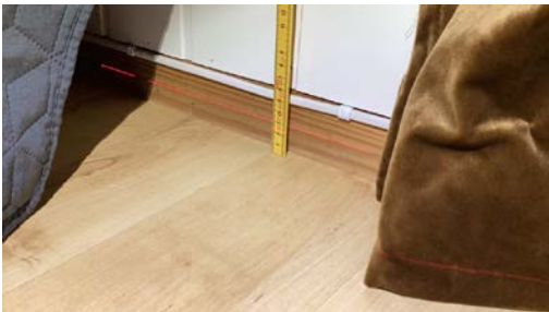
Helningsavvik på 17 mm ble målt på soverom.
