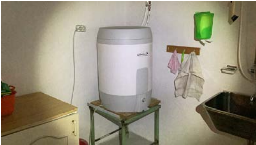
Varmtvannstank på vaskerom.
