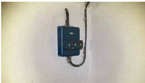
Inntak i kjeller.
