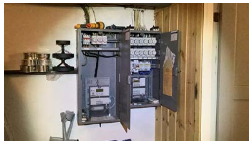
Sikringsskap i kjeller.
