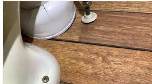
Svelling på laminat ved toalett.
