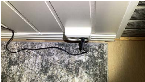
Gulv er ikke ført tilstrekkelig under list.
