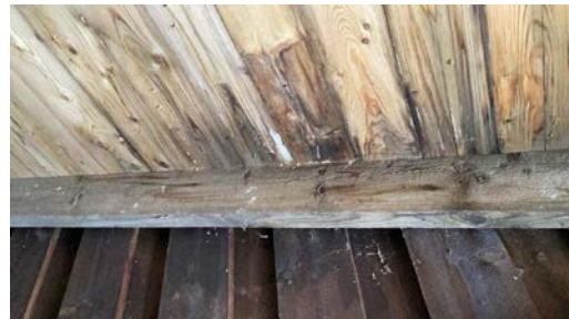
Misfarging på undertaksbord i garasjedel.
