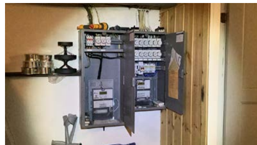
Sikringsskap i kjeller.
