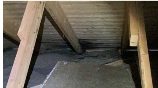
Misfarging på undertak.
