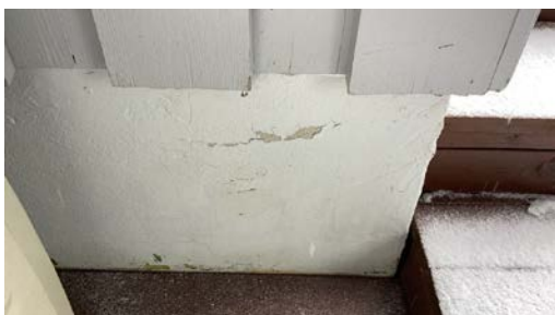
Malingsflass på mur.
