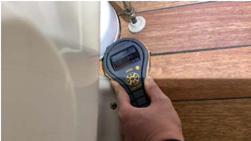
Ved bruk av fuktindikator rundt toalett registrerte jeg unormale verdier.
