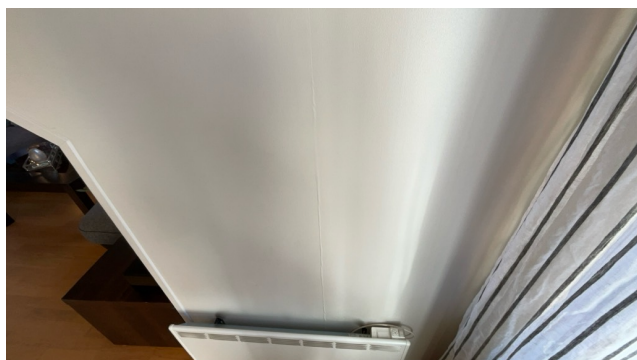
Synlig avvik på vegg i 2.etg.
