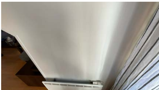
Synlig avvik på vegg i 2.etg.
