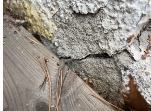
Sprekk i grunnmur.
