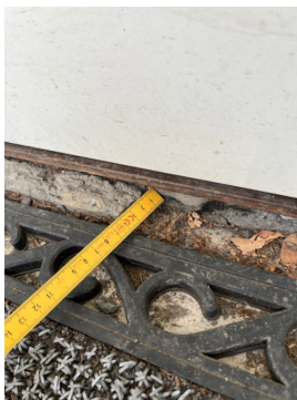
Manglende beslag for ytterdør.
