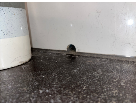
Spalte innebygget bereder
