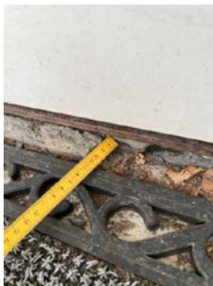
Manglende beslag for ytterdør.
