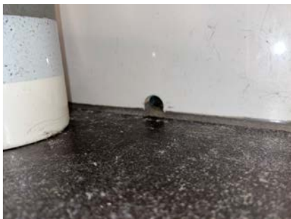
Spalte innebygget bereder
