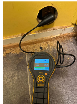
Lav fuktighet i kjøkkenvegg mot dusj
