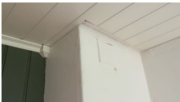
Brennbar materiale er noe tett på pipe og bør utbedres.
