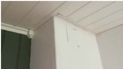
Brennbart materiale er noe tett på pipe og bør utbedres.
