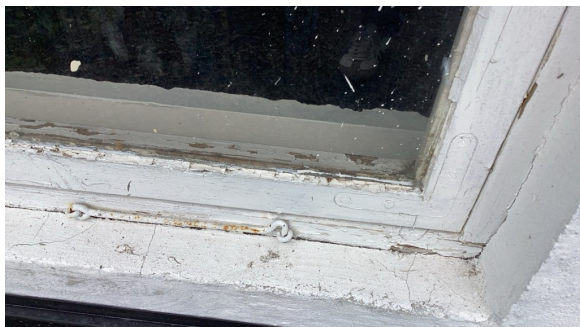
Eksempel på slitasje.
