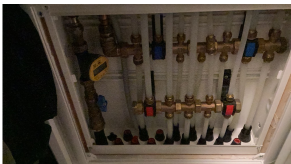
Fordelerskap med hovedstoppekran på teknisk rom.
