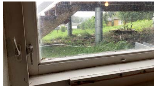
Sprekk i glass på ett vindu.
