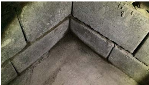
Noe fuktighet i ett veggjørne.
