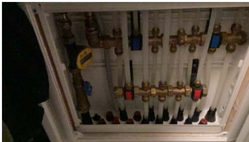
Fordelerskap med hovedstoppekran på teknisk rom.
