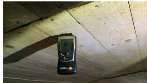
Fukttinnhold i treverk i himlinger på under 20 vektprosent.
