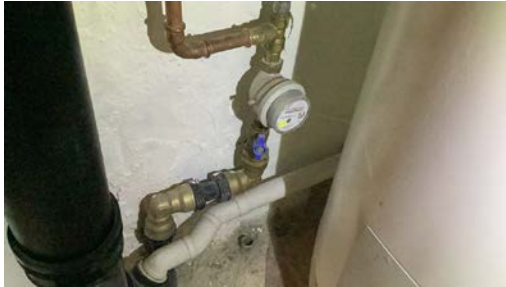
Vannmåler og stoppekran i kjeller.
