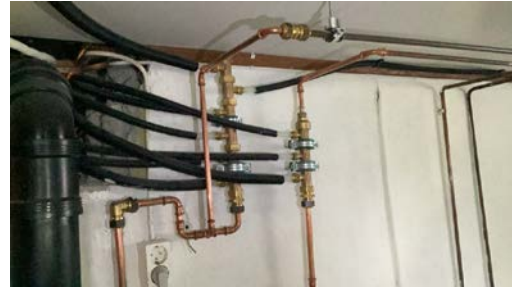
Samlestokk for vannrør i kjeller.
